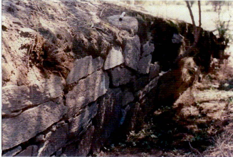
Figura 4.6: Vista de la pared norte y la rampa oeste de la plataforma (E1)
